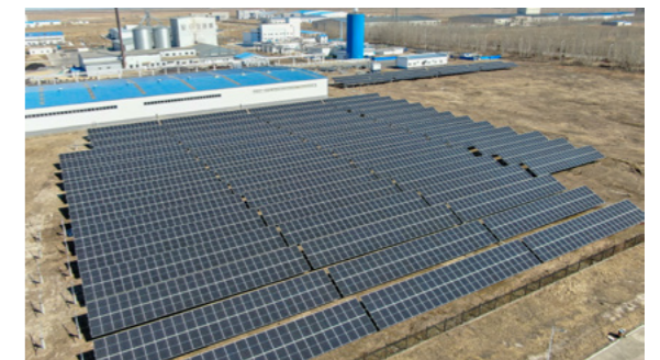
肇东伊利5.99兆瓦分布式光伏电站
