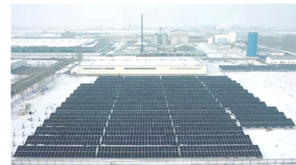
潍坊伊利光伏供电项目
